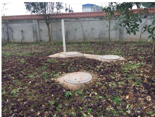
生化池臭气排口
