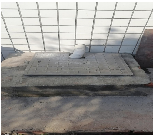
食堂废水隔油池
