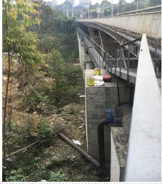
提水管线穿越桥梁
