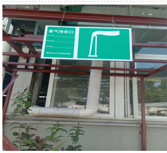
排气筒标识牌
