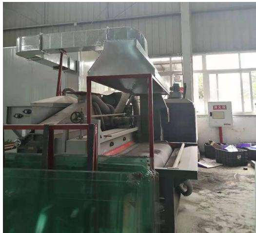
废气收集装置
