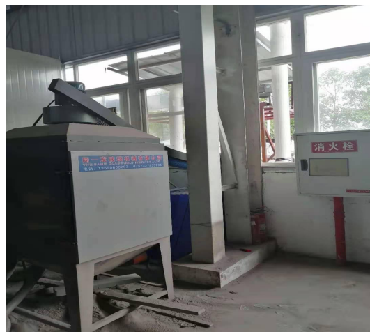
废气处理装置
