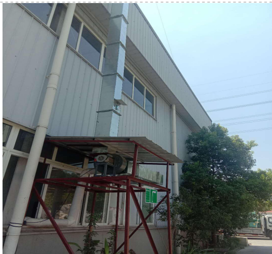
1#排气筒及采样平台
